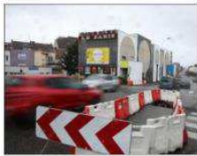
L'avenue Saint-Rémy va vivre deux phases de travaux d'ici mai 2020. Photo RL/Stéphane STIFTER
